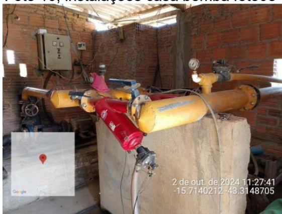
Foto 10, instalações casa bomba foto08
