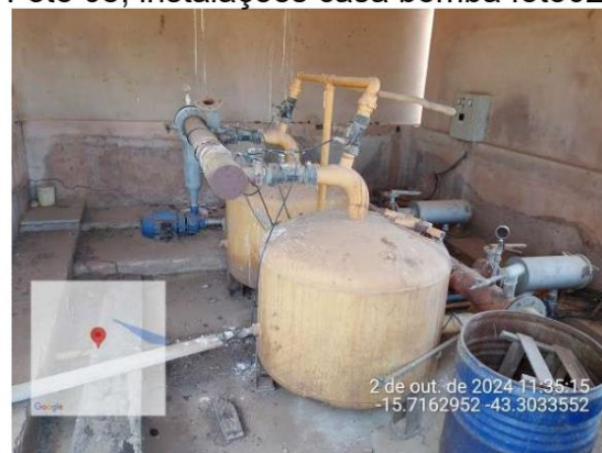
Foto 05, instalações casa bomba foto02
